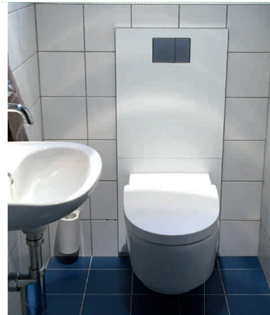
APRÈS : Aspect moderne grâce à Geberit AquaClean Maira, version suspendue avec panneau design
